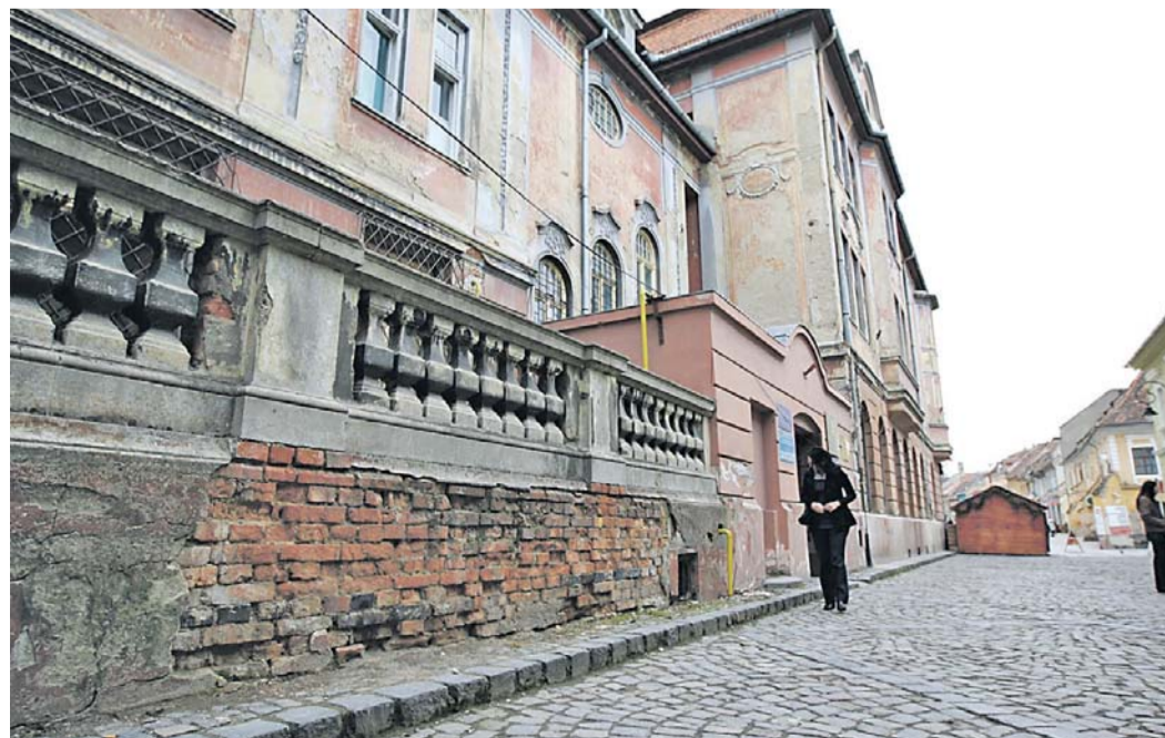
Der desolate Zustand mancher Fassaden wie hier Ecke Zwirngasse/Purzengasse (Apollonia-Hirscher-Haus) in Kronstadt ist nicht nur ein Dorn im Auge des Betrachters sondern gefährdet auch die Fußgänger. Foto: „ Bună ziua Brașov “
