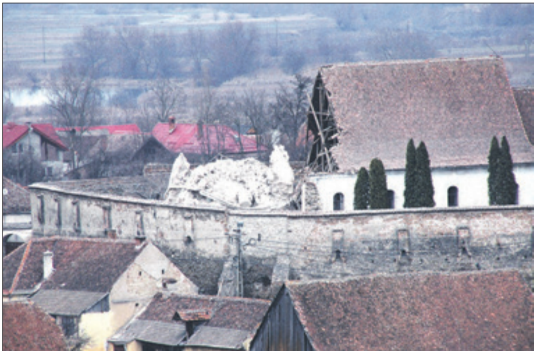
Ein Bild der Verwüstung: der herrliche Turm liegt in Trümmern und hat auch einen Teil des Kirchenschiffs zerstört. Aufnahme vom 20. Februar 2016, einen Tag nach dem Einsturz. Foto: Peter Simon
