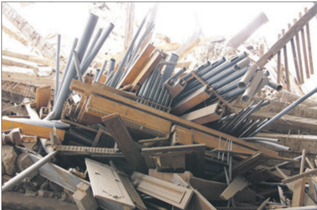
Der eingestürzte Turm begrub auch die über 100-jährige Orgel unter sich. Über ein Viertel der Kirche ist komplett zerstört. Foto: Peter Simon
