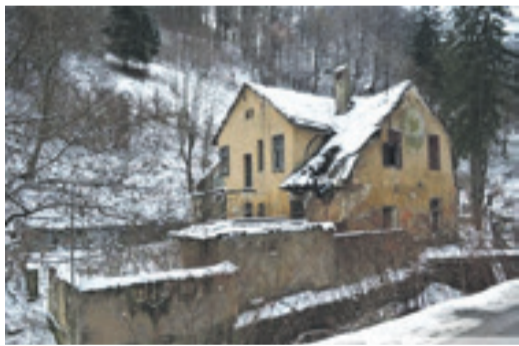
Das Wirtshaus verfällt immer mehr.
