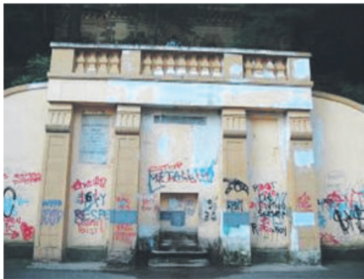
Vor der Reinigung und Renovierung.
