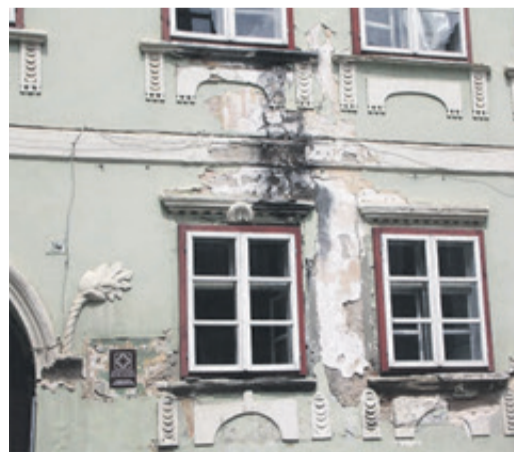
Detail aus der Fassade des gleichen Hauses im Jahr 2018. Fotos: Bildarchiv W. Halbweiss 2018
