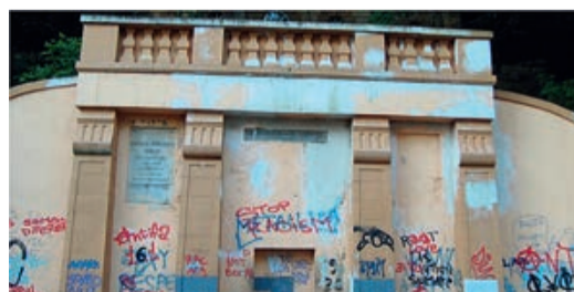
Häßliche Schmierereien verunstalten die Fassade.
