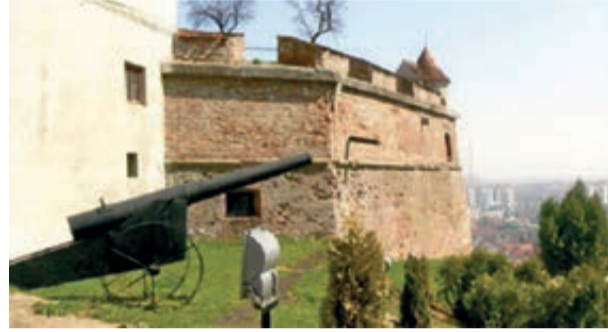
Nicht nur die Außenmauern benötigen dringender Renovierungen und Konsolidierungen.
