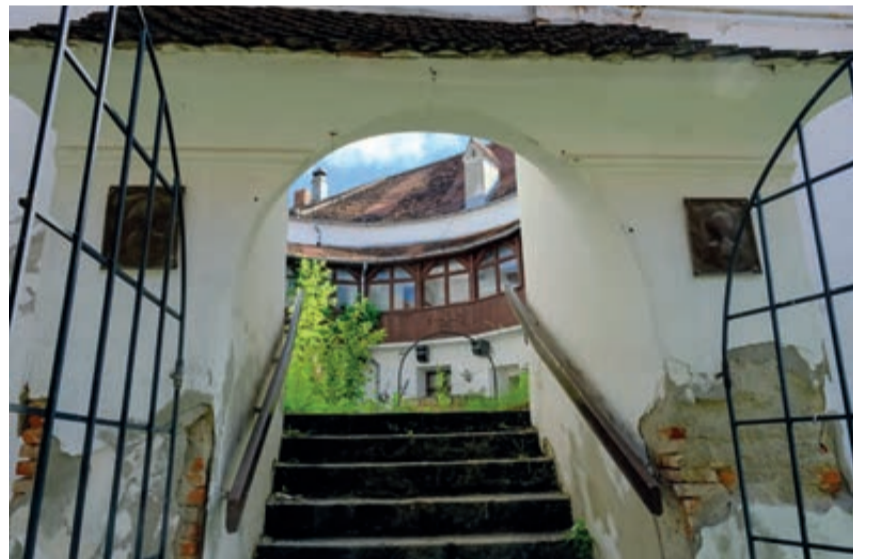
Die Tore öffnen sich wieder, und der Verfall wird sichtbar.
