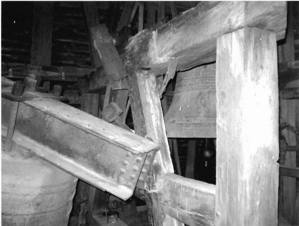
Glockenschaden in Bartholomae, Oktober 2006 (Foto: K. Boltres)
